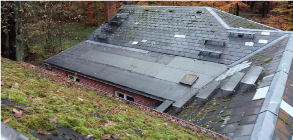
Abbildung: Fotoaufnahme mit einer Dachansicht der Villa Mutzenbecher, aufgenommen aus einem der Notausstiege. Eigene Aufnahme
